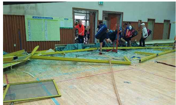
(b) 곡성○○초등학교 체육관 유리 파손(태풍 타파, '19. 9월)
