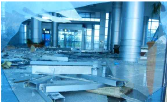
(a) 마린센터 시설 파손(태풍 볼라벤)
