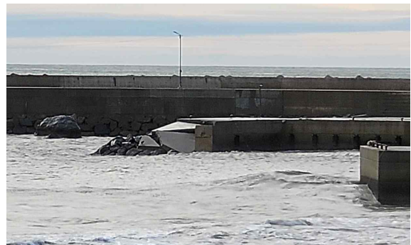
(b) 만성리 방파제 파손(태풍 힌남노)
